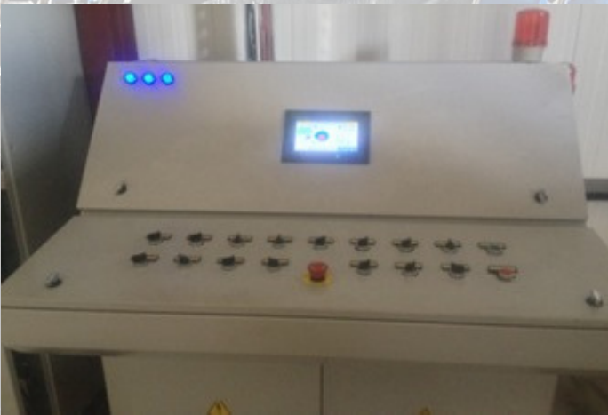
Piyano Tipi Elektrik Pano ve Kontrol Sistemi
